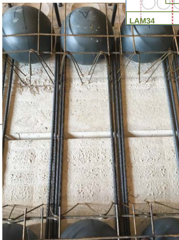
figuur A-11 Proefstuk KA18 1054 boven / 1047 onder
