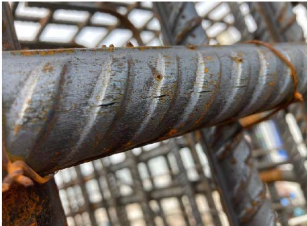
Figuur 2-1: Defect ALPA betonstaal
